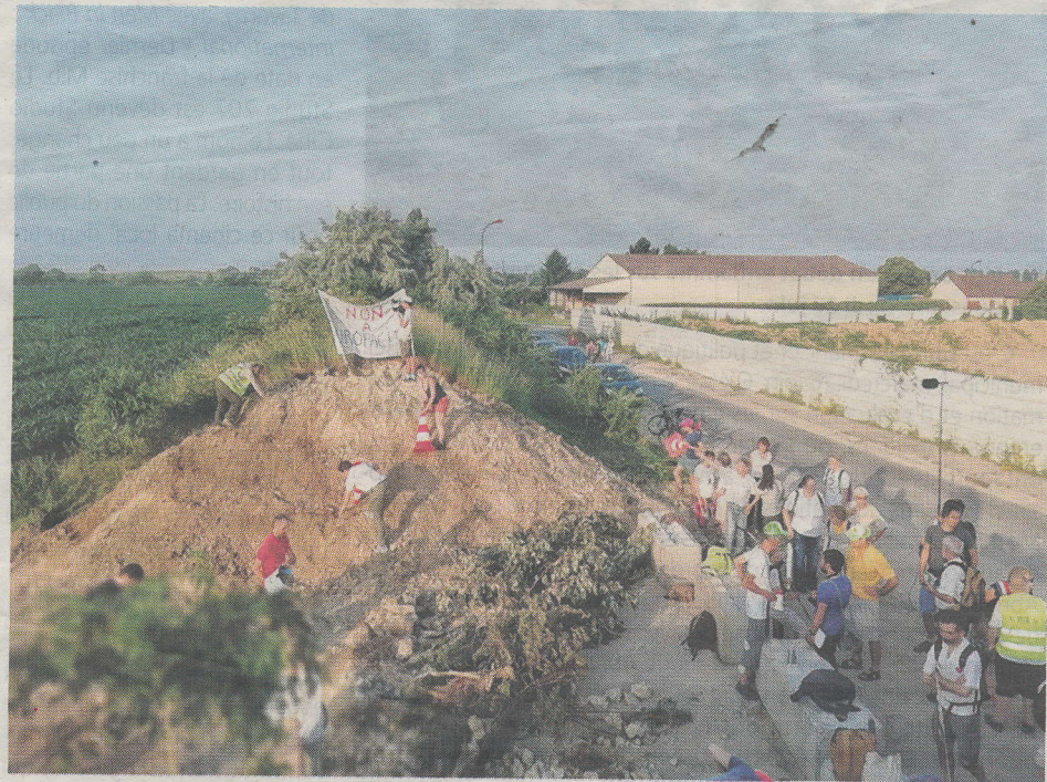
Depuis mercredi 26 juin, le chantier de construction de la ligne 17 du métro est occupé par des opposants à l'aménagement de la Zac de Gonesse.
